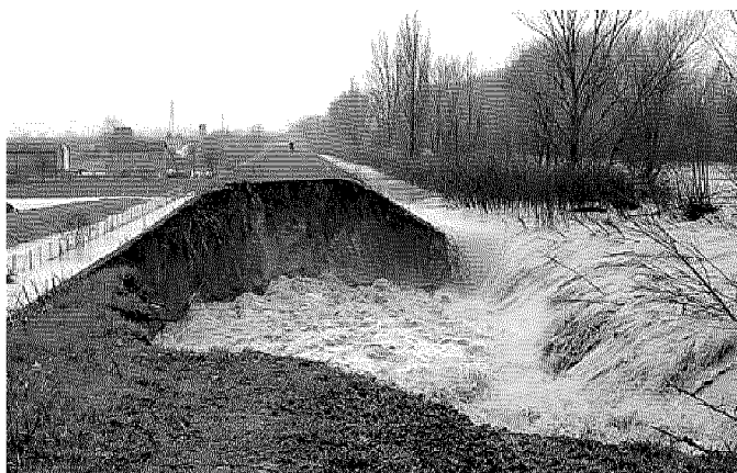
L'argine rotto nei pressi di San Matteo: l'origine del disastro
