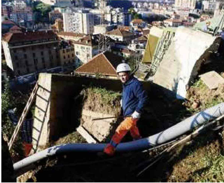
Iniziati i lavori per la messa in sicurezza della frana di San Cipriano BALOSTRO
